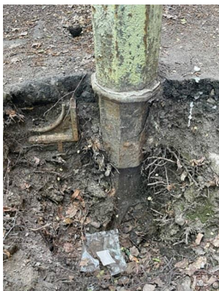
Рис. 3. Подземная часть чугунного литого столба Дома трудолюбия (г. Кронштадт, ул. Фейгина, 7–9). Фотография Д. И. Щепетильник, 2022 г.
