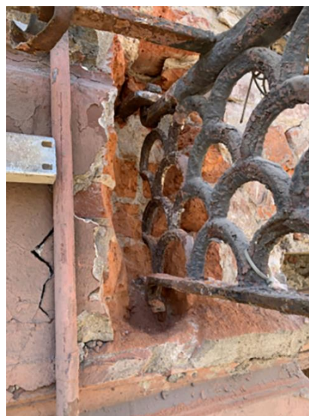
Рис. 8. Раскрытие крепления боковой части обвязки козырька в кирпичную кладку стены здания. Фотография Ю. А. Горелик, 2022 г.
